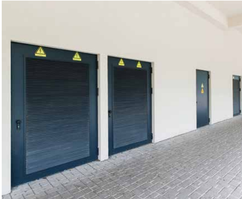
Mehrzwecktür mit Trafogitter
