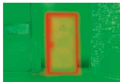
Perte d'énergie visible sans porte avec rupture de pont thermique
