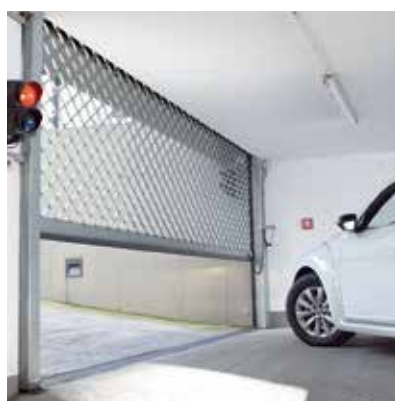
Grille roulante TG-A dans un parking souterrain
