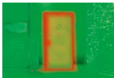
Zichtbaar energieverlies zonder thermisch geïsoleerde deur
