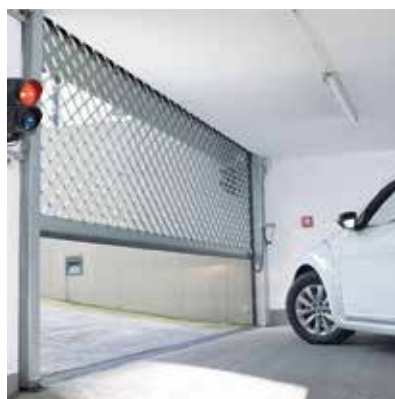
Rolhek TG-A in een ondergrondse parkeergarage
