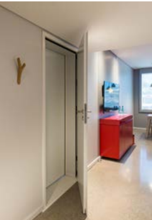
Schallschutz der Extraklasse durch hintereinander montierte Durchgangstüren.
