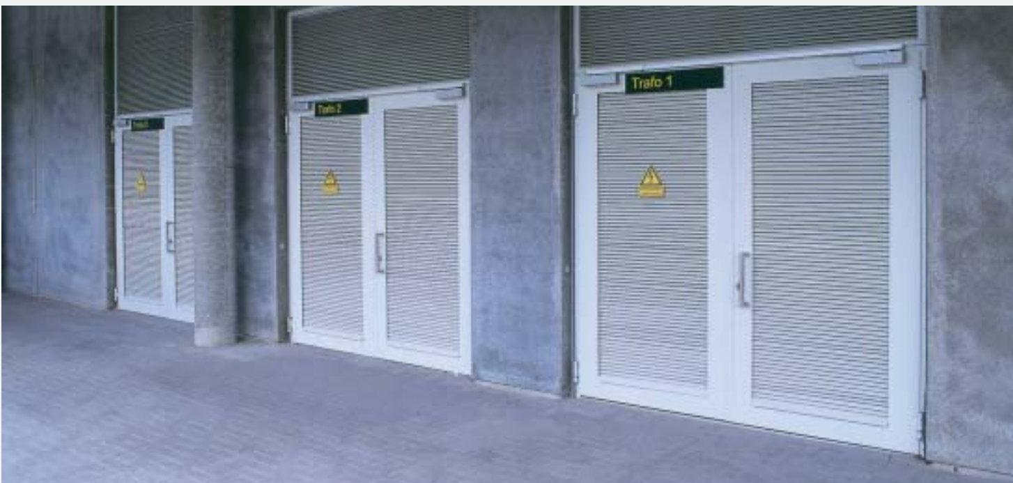
dw 64-2 "Teckentrup" met grote traforoosters in het deurblad en in het bovenpaneel.
