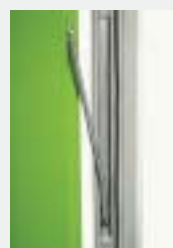
Verdekt liggende kabelovergang
