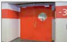
Brand- en rookwerende deuren
