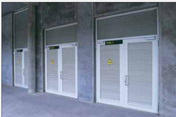
Trafodeuren, dw 54-2 "Teckentrup"
