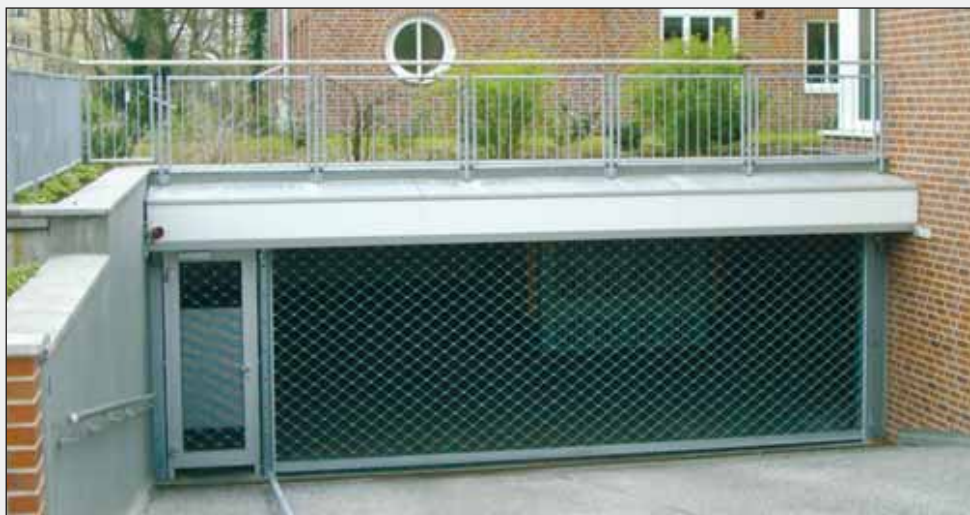
Griglia avvolgibile con porta pedonale laterale in garage sotterraneo.
